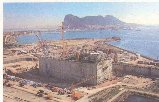
Imagen de la plataforma regasificadora en el puerto de Algeciras
